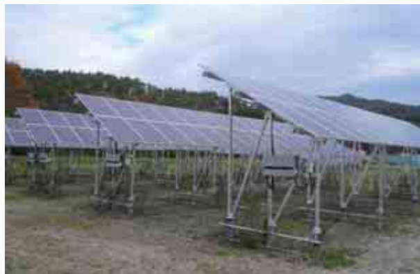
営農型発電設備。下地の牧草を刈り取ったばかりでトラクターのタイヤ跡が残る
